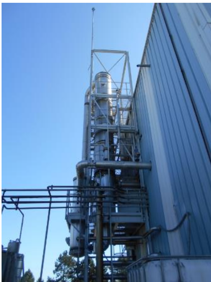
Figure 13 : Colonnes de distillation du bouilleur existant
